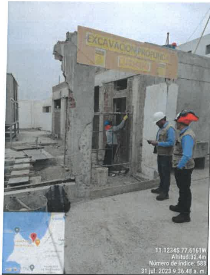
Ilustración 1: Verificación de ATS en campo.
