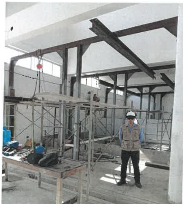
Ilustración 2: Supervisor especialista en el Área de fríos, verificando la instalación de vigas soporte.
