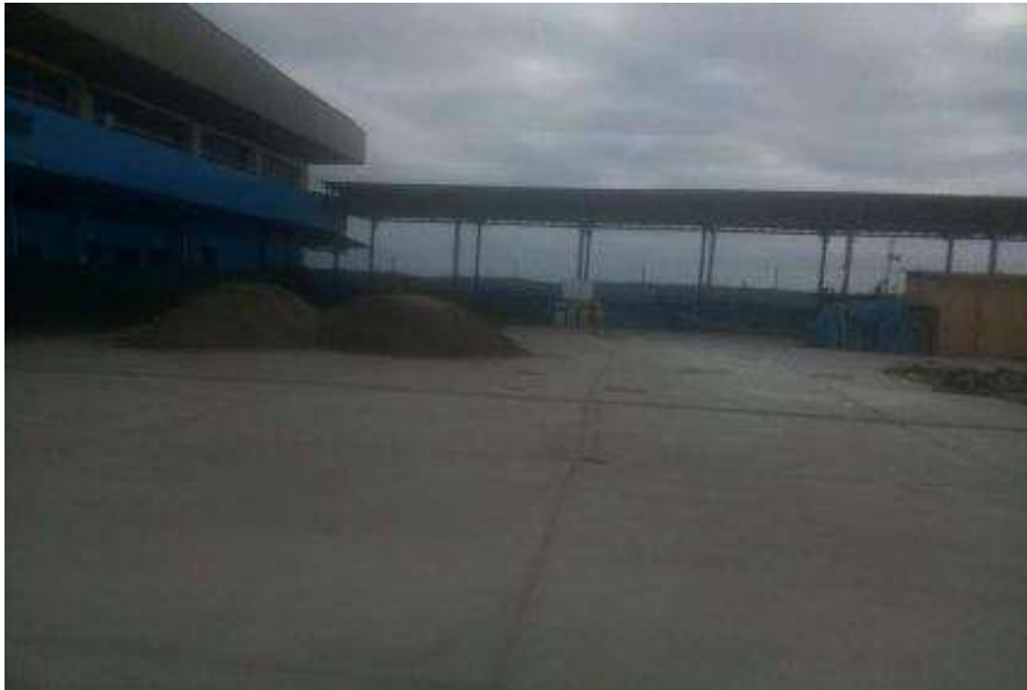
FOTO No. 05 VISTA FOTOGRAFICA DE LA DISPOSICION DEL MATERIAL DE MATERIAL DE RELLENO.
