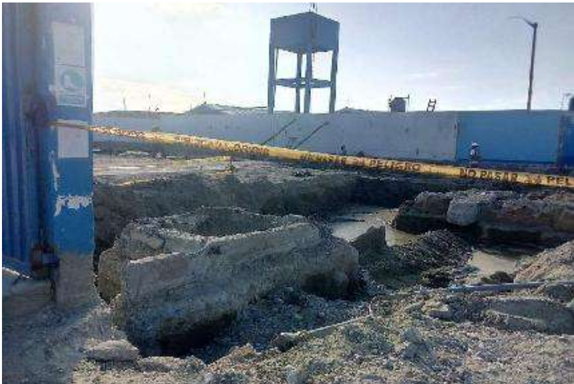
FOTO No. 16. TOMA FOTOGRAFICA DE LA EXCAVACION DE LA ZANJAS DE CIMENTACION DEL CERCO PERIMETRICO.
