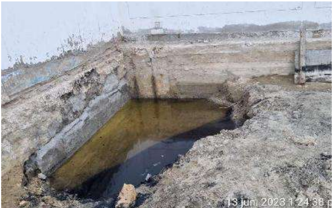
FOTO No. 12 TOMA FOTOGRAFICA DEL AREA DONDE SUPUESTAMENTE AFLORA PETROLEO CRUDO, LA CUAL FUE PUESTA EN CONSULTA AL PROYECTISTA.
