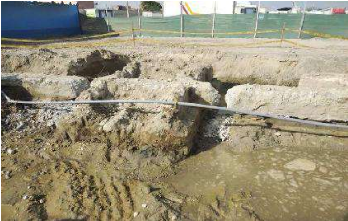
FOTO No. 15. TOMA FOTOGRAFICA DE CABLERIA DESCUBIERTA DURANTE LA DEMOLICION Y EXCAVACION DE LA ZANJAS DE CIMENTACION DEL CERCO PERIMETRICO.
