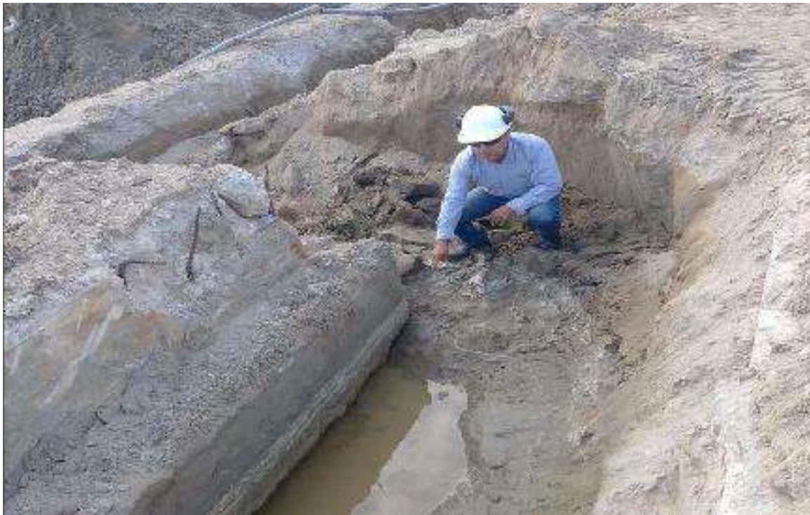
FOTO No. 14 TOMA FOTOGRAFICA DEL AREA DONDE SE EDIFICARA EL BLOQUE " A" , EL ESPECIALISTA EN ESTRUCTURA DE LA SUPERVISION, VERIFICANDO LA ESTRUCTURA DE CIIMENTACION EXISTENTE,, EN LA ZONA DEL CERCO PERIMETRICO DEMOLIDO.
