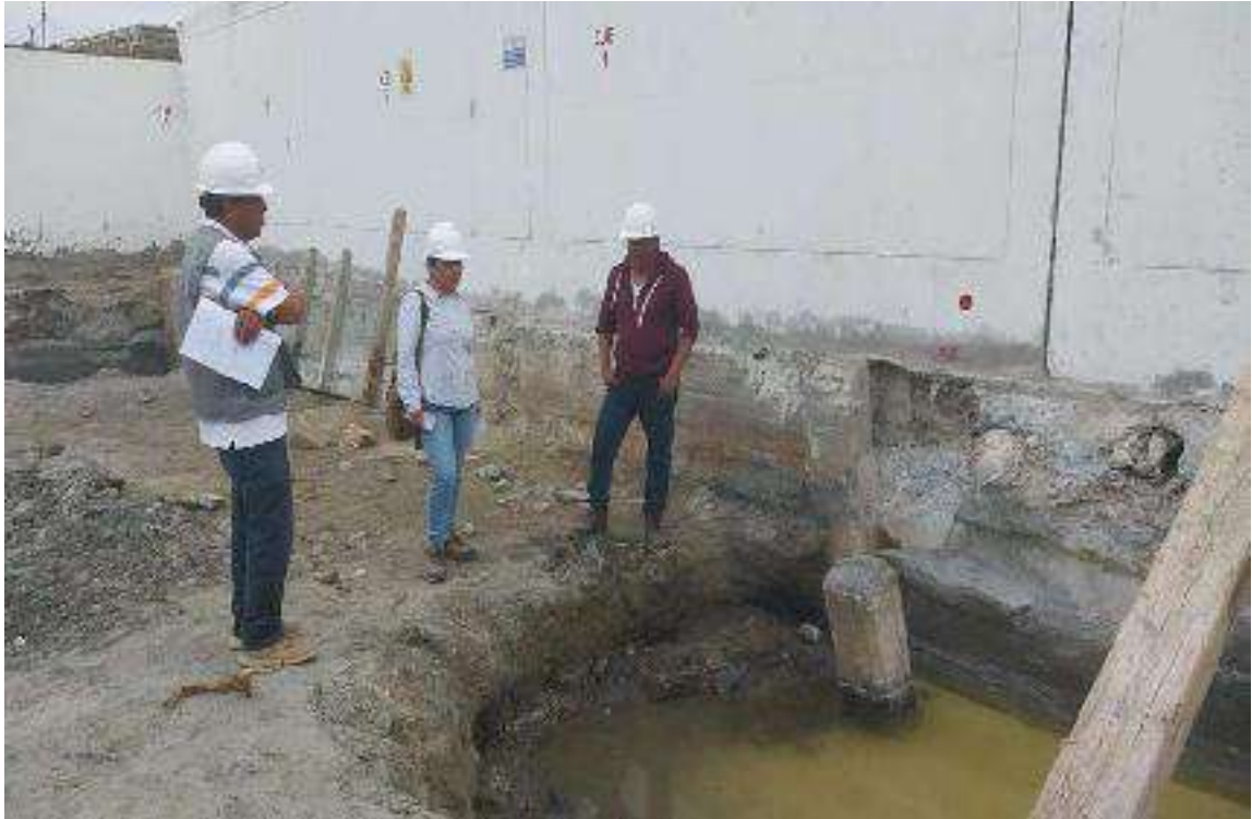
FOTO No. 11 TOMA FOTOGRAFICA EN EL AREA DONDE SE EDIFICARA EL BLOQUE "B" CON PRESENCIA DE LA ING. LIZHET ROXANA RDRIGUEZ NEYRA, COORDIADORA DE OBRA - FONDEPES.
