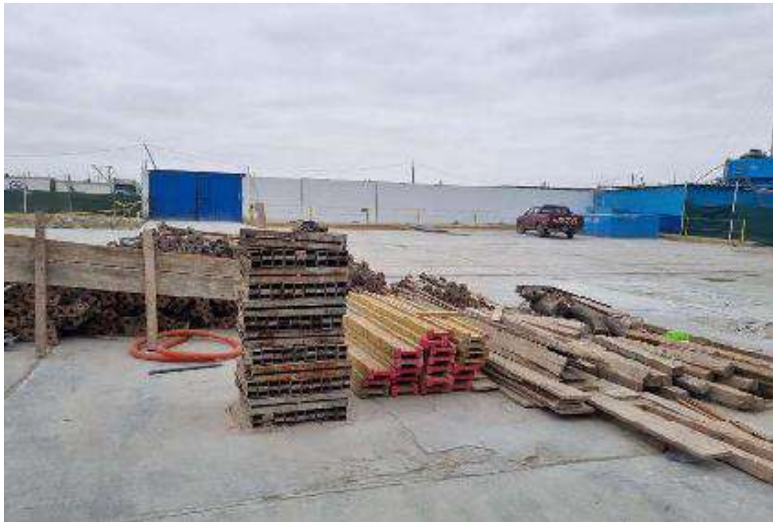
FOTO No. 04 VISTA FOTOGRAFICA DE LA DISPOICION DE LOS MATERIALES INSUMOS PARA ENCOFRADO Y DESENCOFRADO, PUESTOS EN OBRA.
