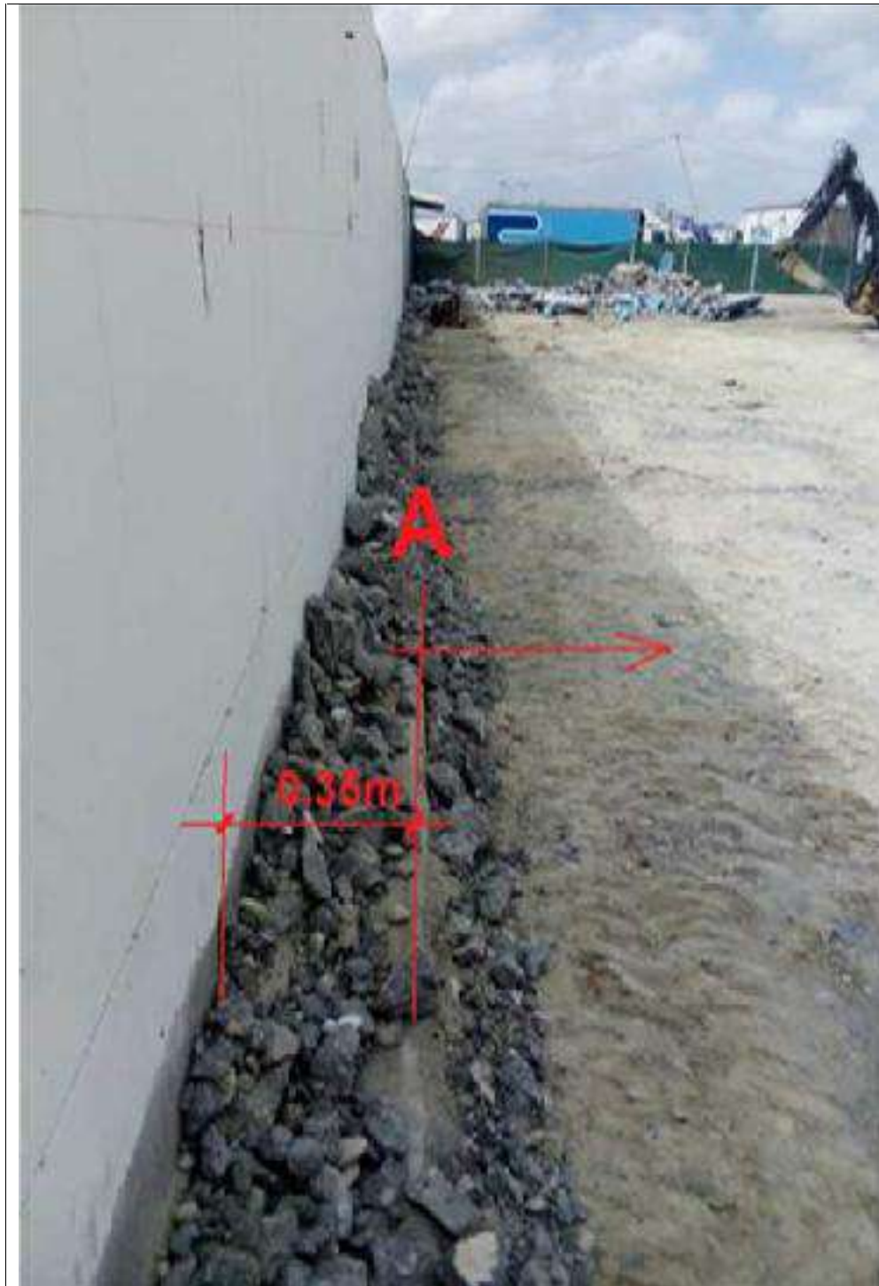
F31: Se observó una superposición del cimiento de cerco (0.17 m + 0.18 m), con la Platea de cimentación a ejecutar. Por ello, se determinó que se desplace el trazo en el Bloque "B", con fines de no afectar la estabilización del muro perimétrico.
