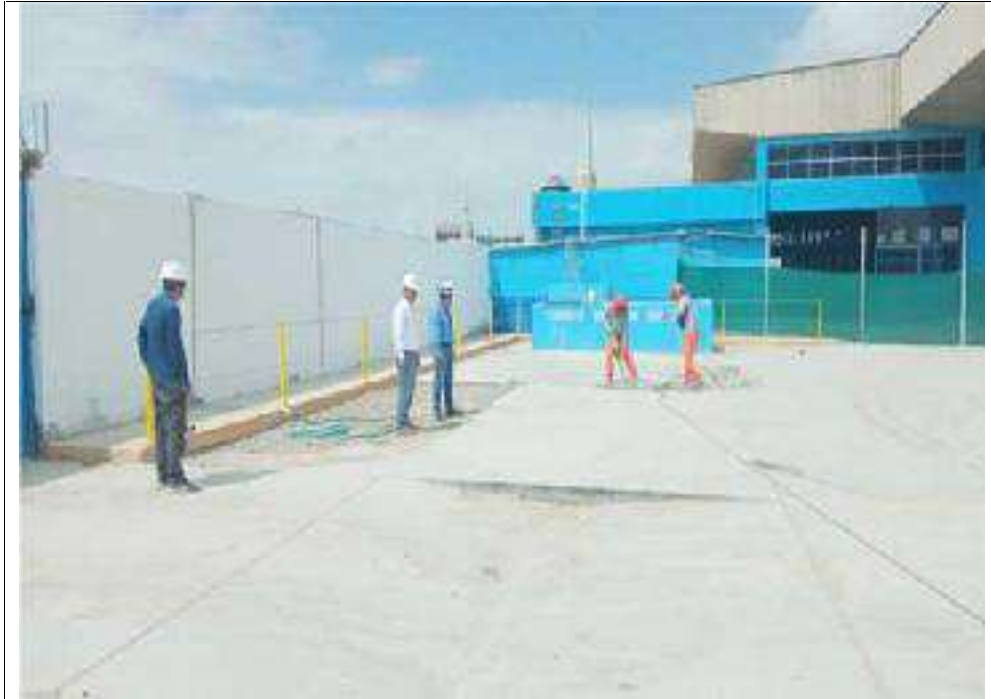
F13: Demolición de los bordes de la losa de concreto armado en zonas de Cisternas.
