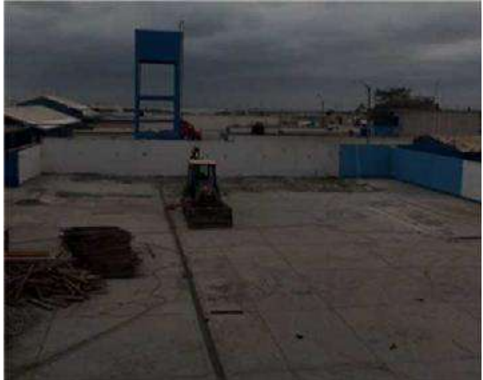
F21: Demolición de losa en bloque "B" (SS. HH. y VESTIDORES), se usa Retroexcavadora con martillo.
