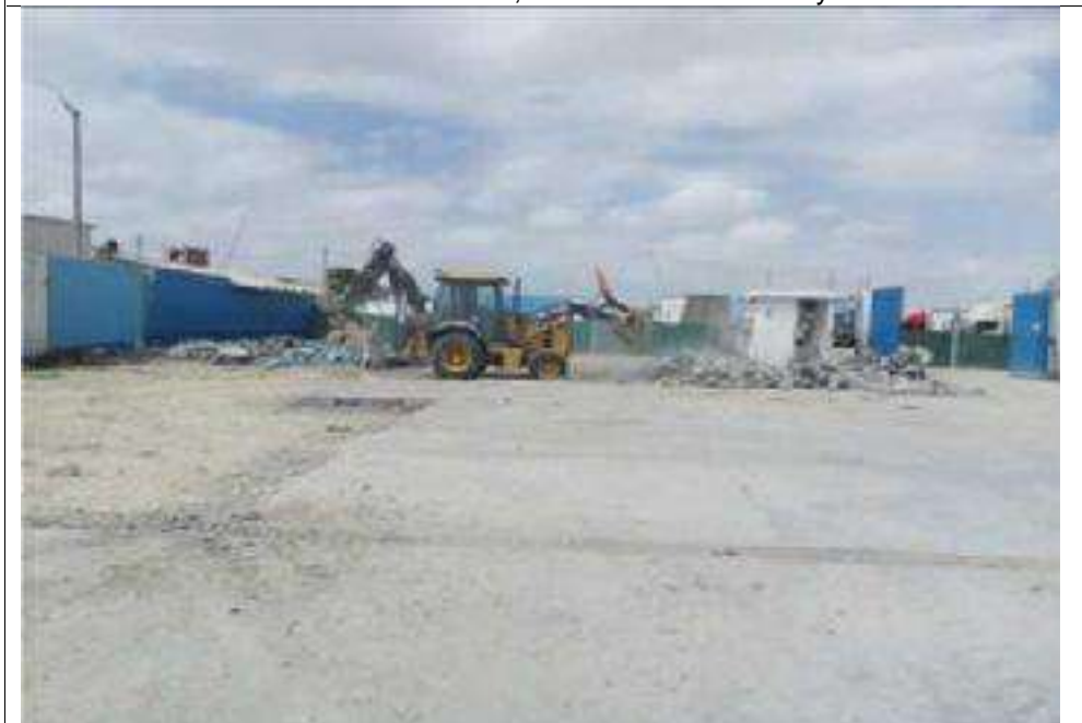
F26: Demolición de Cerco Perimétrico. Se constata que, la Caseta de Seguridad se encuentra sin demoler.
