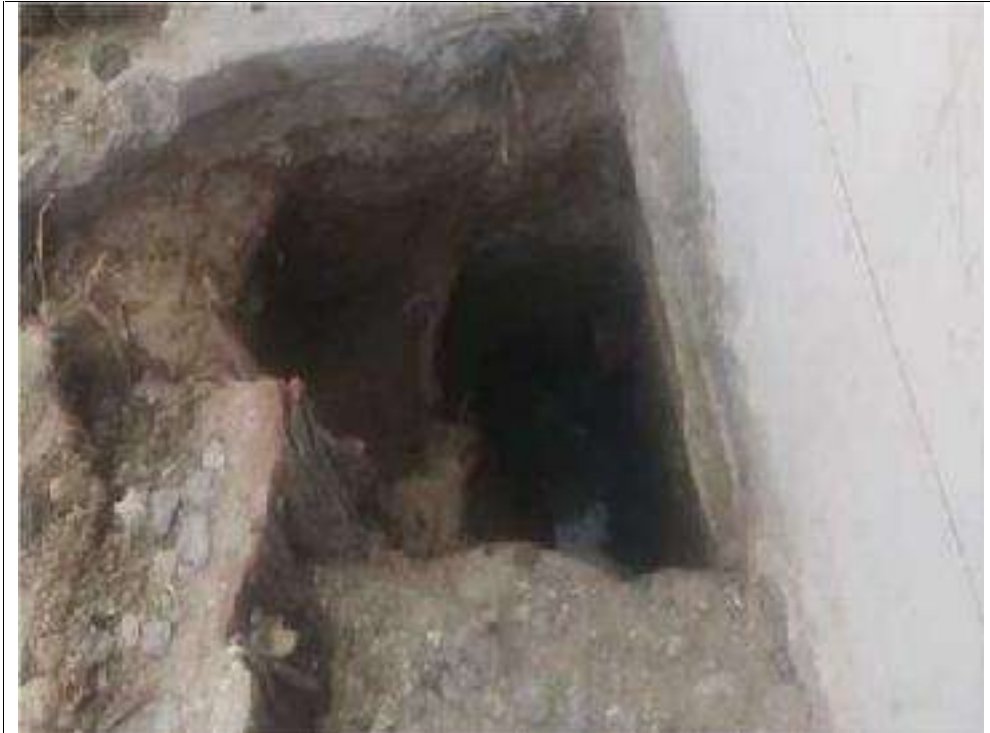
F17: Se constato la presencia de agua (nivel freático) a un 1.50 m de profundidad.
