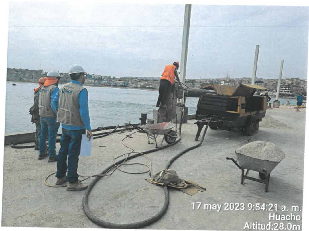
Ilustración 15: Supervisión de los trabajos de arenado en estructuras metálicas existentes en el muelle.
