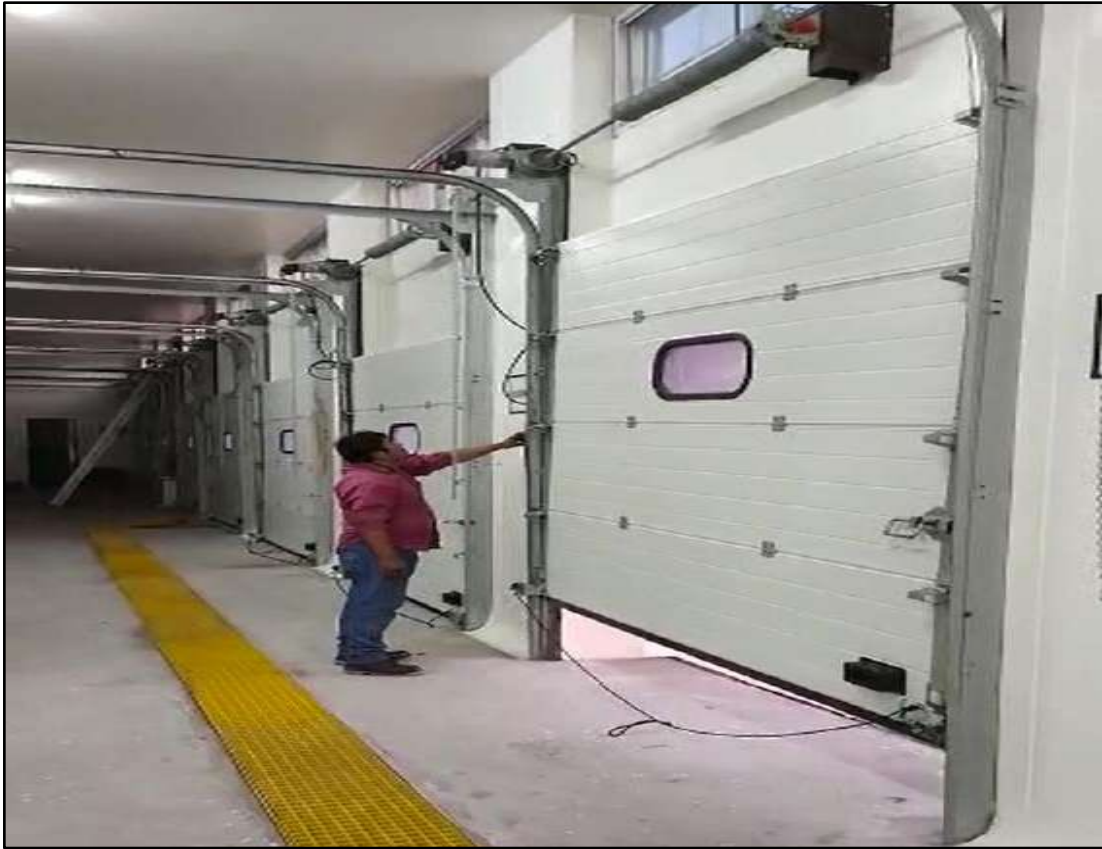
FOTO N° 03: Funcionamiento de las puertas seccionables en tareas previas.
