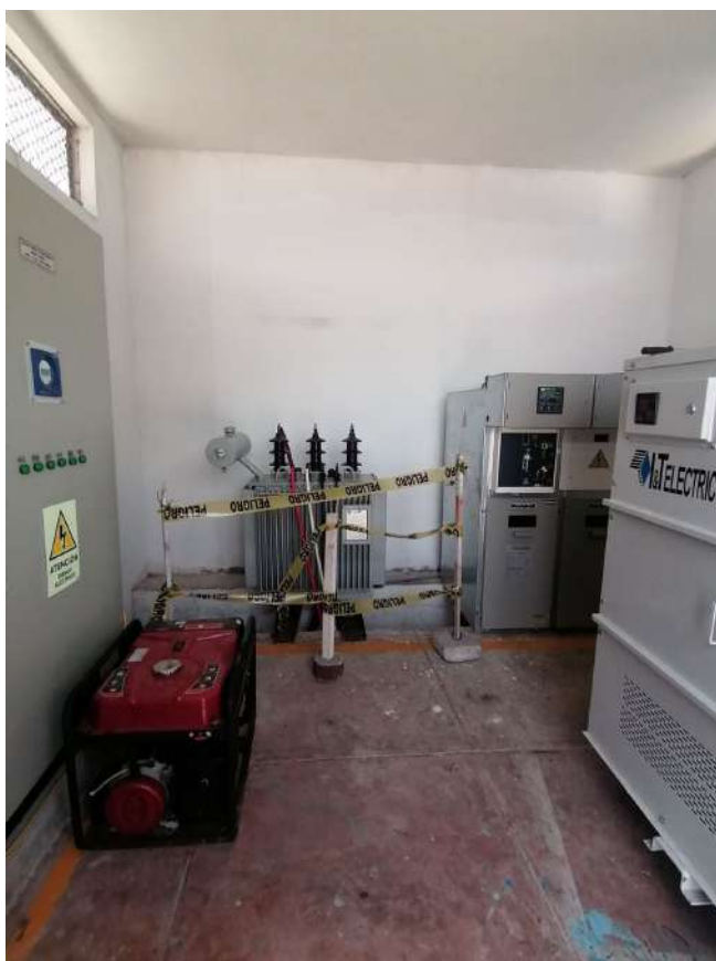
Transformador existente instalado provisionalmente. Transformador Seco nuevo de 250 kVA almacenado al interior de Subestación.
