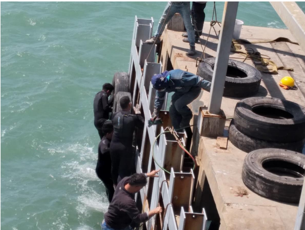
FOTO N° 02: PINTADO DE VIGAS H Y COLOCACION DE TERCERA HILERAS DE NEUMATICOS LADO SUR
