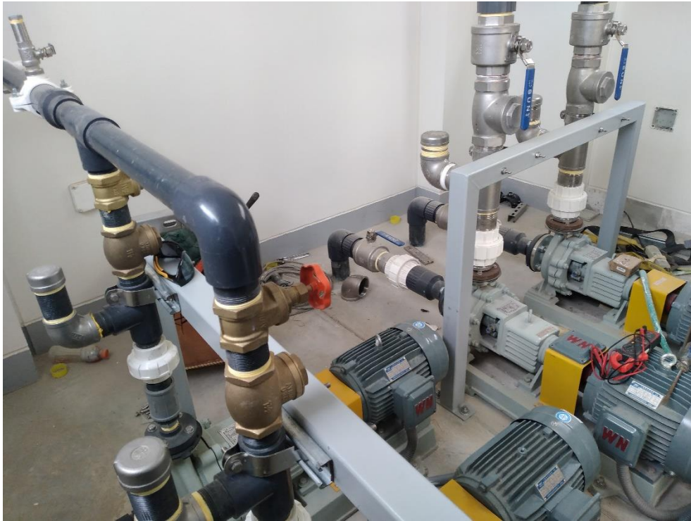
11.0 Se culminó con la instalación de las electrobombas de agua salada y potable en la caseta de tanque elevado
