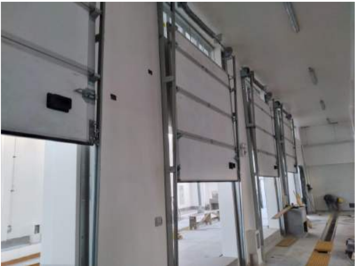
2.0 Se realizó el montaje de instalación de ventanas seccionables en el área de tareas previas culminado al 100%
