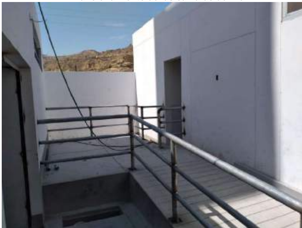
8.0 Se está ejecutando la fabricación de la baranda en la rampa del ingreso de caseta de osmosis
