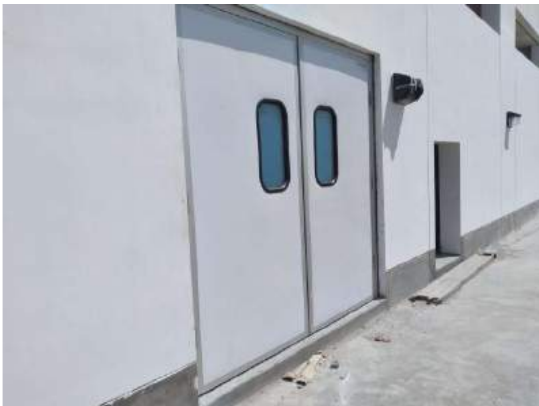
2.0 Se realizó el montaje de instalación de puertas de alto impacto en área de frios culminado al 100%
