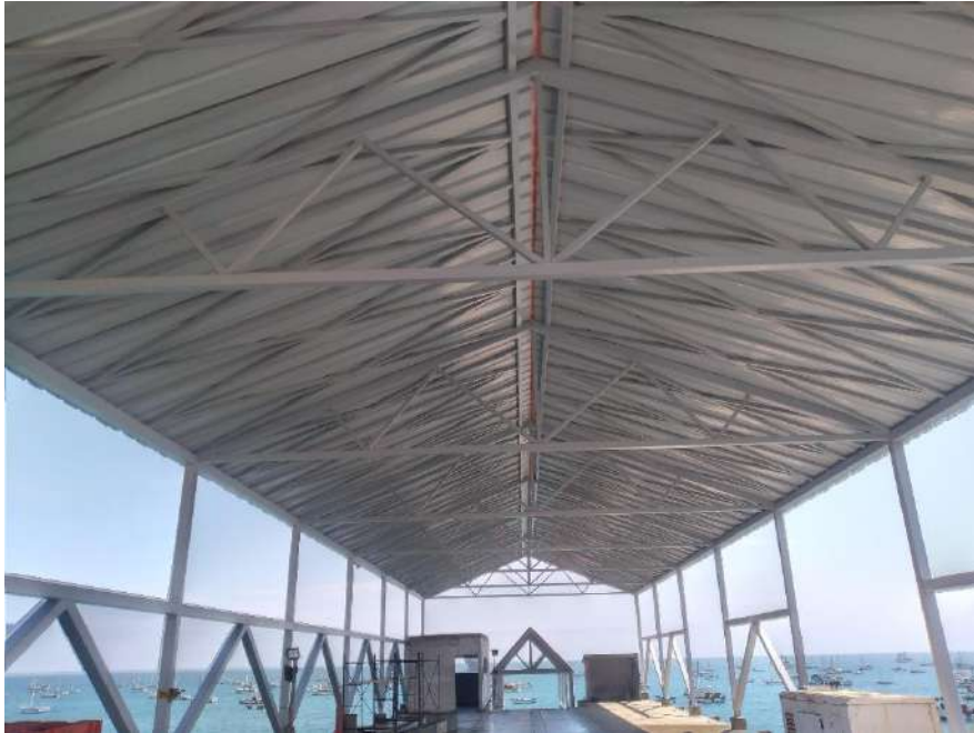
1.0 Se realizó el montaje de estructura, cobertura y el pintado en techo de Mulle plataforma alta culminado al 100%
