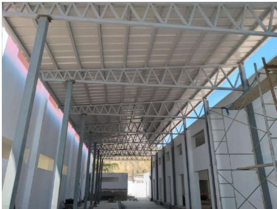
4.0 Se realizó montaje de estructura e instalación de cobertura en techo de patio de sociales
