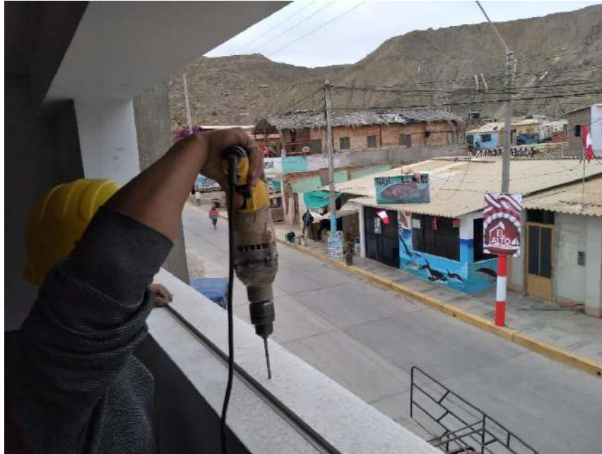
11.0 Se está ejecutando la instalación de aluminios para la colocación de ventanas.
