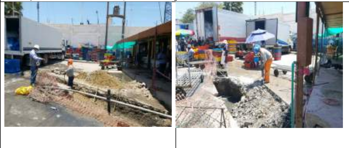
Foto 10 y 11: Demolición de losa y excavación de zanja para el tendido del desagüe al colector público
