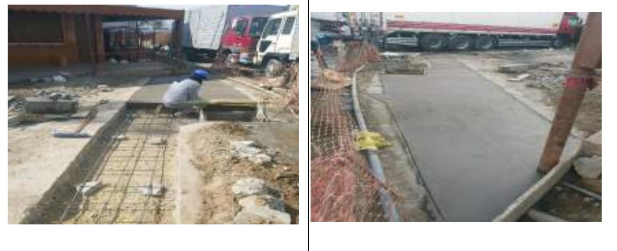
Foto 15 y 16: Reposición de la losa de concreto en el ingreso al DPAI
