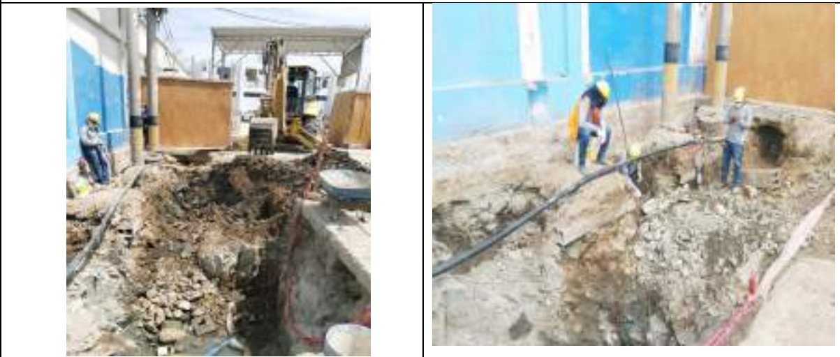
Foto 08 y 09: Excavación en terreno rocoso para la colocación de la cámara de bombeo N° 06, pozos de tierra y buzón eléctrico para el sistema de media tensión, ubicados en el ingreso al DPAI
