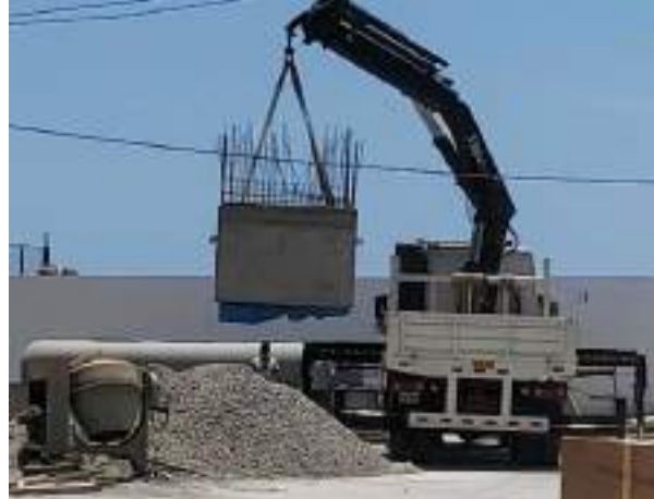
Foto 32 y 33: Izaje de la cámara de bombeo de concreto prefabricado para su colocación final
