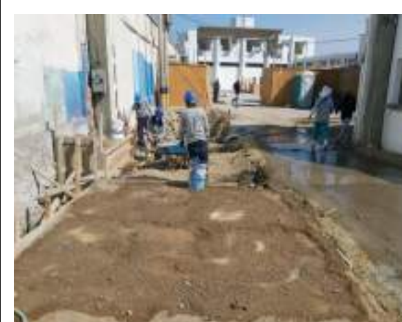
Foto 19 y 20: Curado de reposición de la losa de concreto en el ingreso al DPAI
