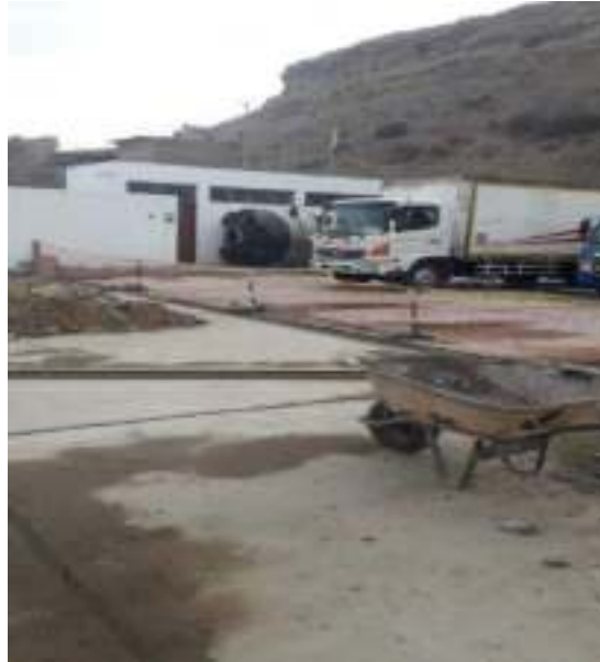
FOTO 01: SEÑALIZACION DE SEGURIDAD EN OBRA
